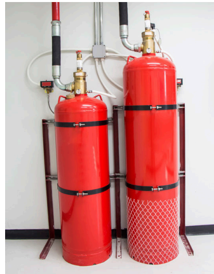
Extinction automatique à gaz
